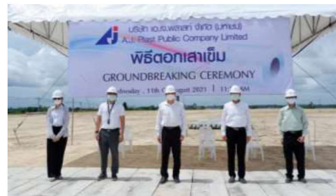
ภาพพิธีดอกเสาเข็มเริ่มโครงการก่อสร้างโรงงานผลิตฟิล์มแห่งใหม่เพื่อรองรับความต้องการของลูกค้า
